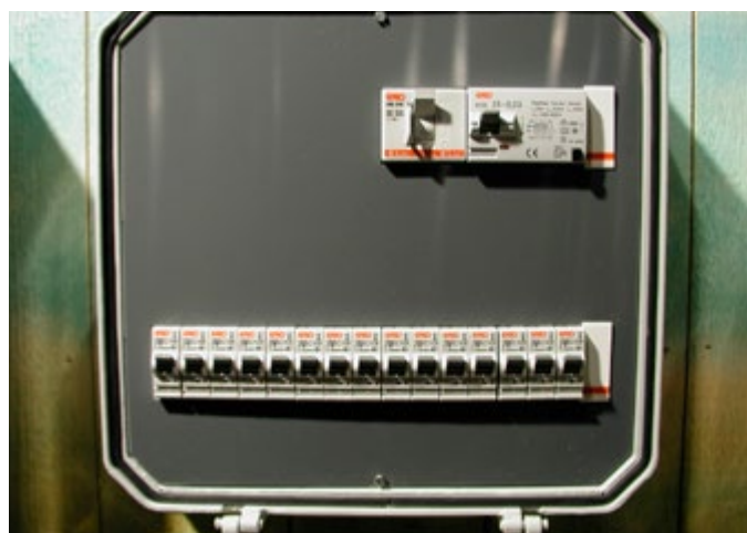
Elcentral med jordfelsbrytare. Om jordfelsbrytaren löser ut är det ett tecken på att något är fel. Är felet till exempel en trasig gummikabel är det bara att byta den. Men om det är fel i den fasta installationen måste du kalla på din elinstallatör.
