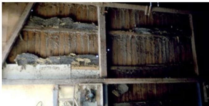
Om råttorna kommer in i en mineralullisolerad vägg kan det se ut så här bakom väggbeklädnaden efter några år.
