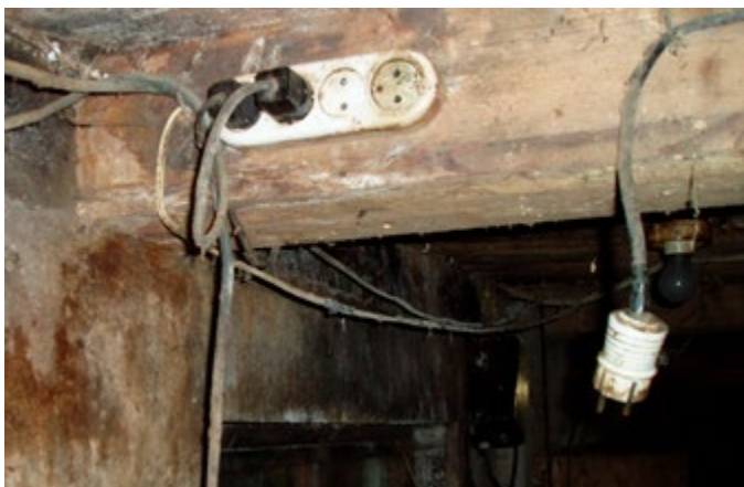
Gummikablar får aldrig ersätta den fasta installationen. Gummikablar får endast användas för tillfälliga anslutningar av flyttbara maskiner och apparater. Läs mer om detta i kapitel 4 El och åska.
