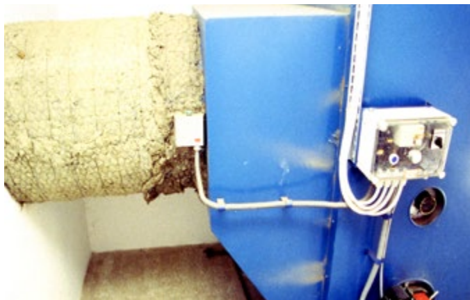
Varmluftskanalen i pannrummet ska alltid vara isolerad.
