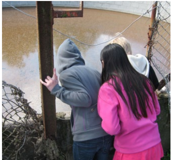
Det gäller att så långt som möjligt förebygga olycksfall. Om du har barn på gården ska verkstaden och andra farliga utrymmen alltid vara låsta. Trasiga skyddsnät som här på bilden får naturligtvis inte finnas.
